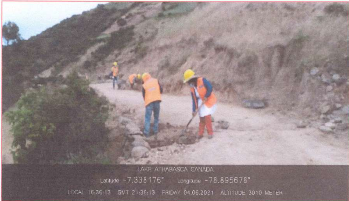
FOTO N° 03: En la imagen se observa el relleno de un tramo erosionado del camino vecinal que se encuentra dentro de la calzada para dar una buena transitabilidad.
